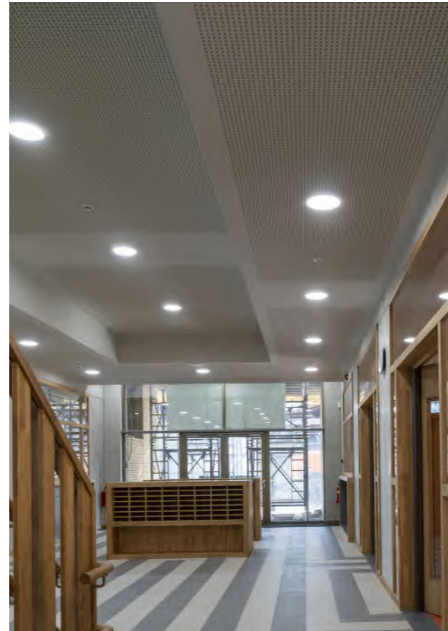
inbouw spots t.p.v. systeemplafonds
